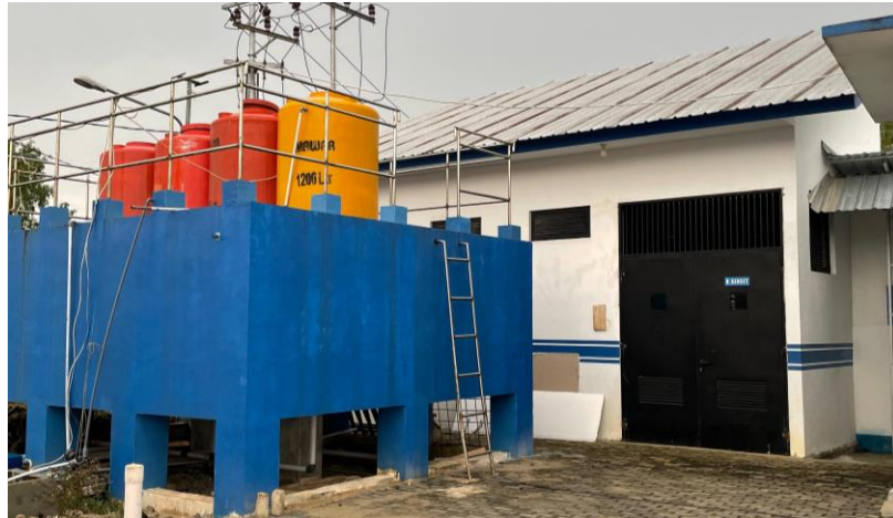
Lampiran 10.14 Gambar Rumah Genset
